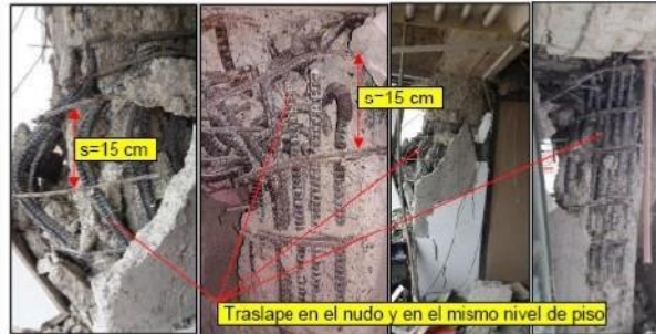
Рис.5. Не вдалий проект розташування арматурних хомутів в колонах будівель
