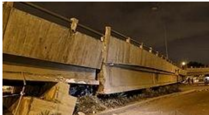
Рис.3. Наслідки землетрусу в Еквадорі (2016)
