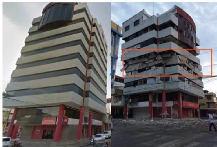
Рис. 4. Руйнування будівель у місті Манта ( Еквадор)
