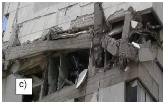
Рис. 6. Недостатня несуча спроможність вузлового з'єднання колони з плитою перекриття
