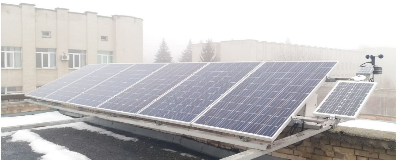
Рисунок 1.7 – Фотоелектрична станція 1.6кВт на будівлі ФЕЕЕМ ВНТУ
