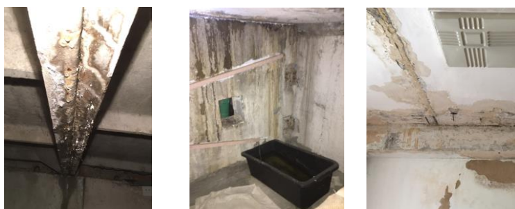
Рис. 1 - Протікання покрівельного килима і руйнування елементів покриття
