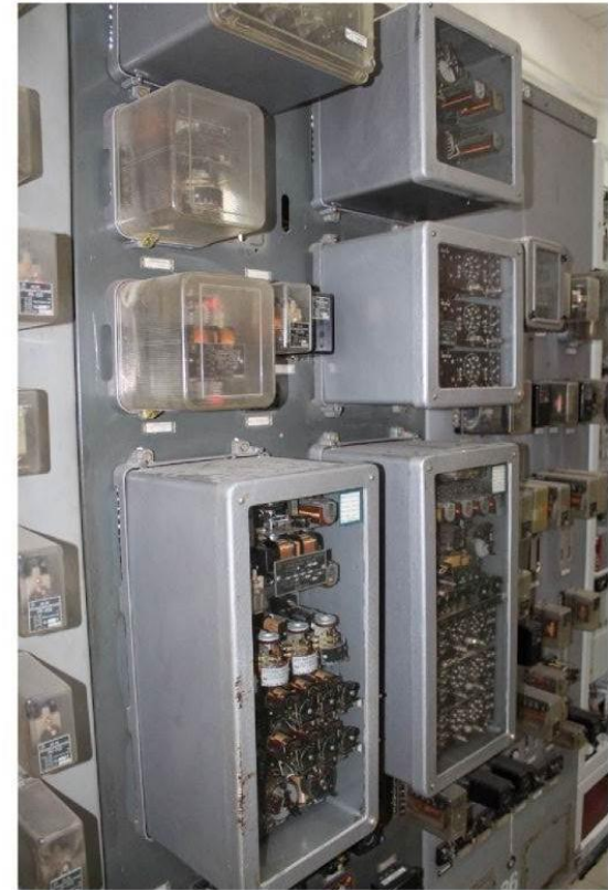
Панель електромеханічного захисту ЭПЗ – 1636
