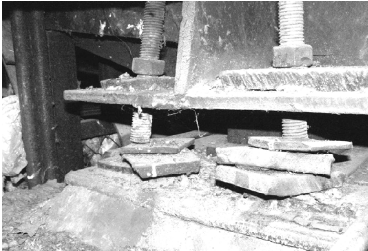
Рис. 3. Типовий стан шарнірно-рухомих опори металевих ферм каркасу. Руйнування анкерних болтів.
