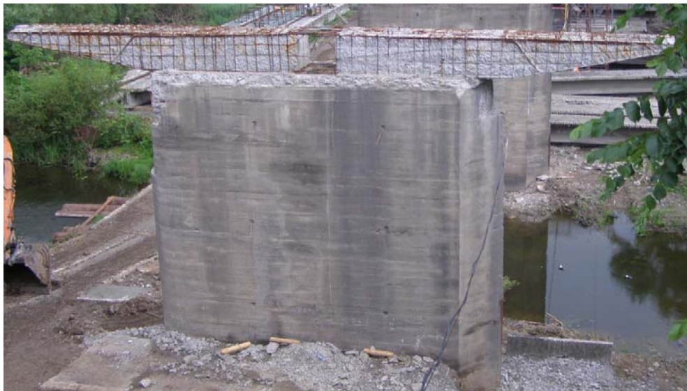
Рис 1. Типова опора мосту через р. Сіб у м. Гайсин після оббивання слабого бетону. Масова шарувата корозія верхньої (робочої) арматури внаслідок дефектів захисного шару та тривалого замочування.
