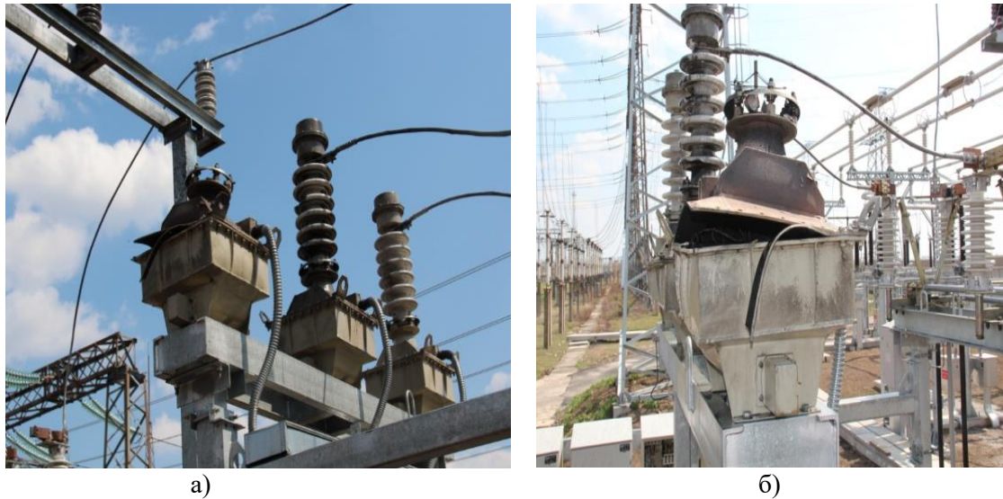
Рисунок 2 – Пошкодження вимірвальних трансформаторів напруги
