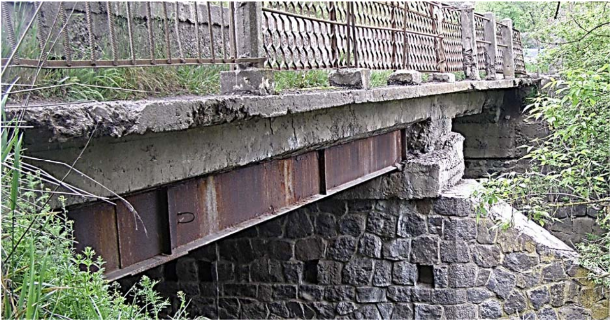
Рис. 2. Стан мостової споруди через р. Сіб на 2020 рік: корозія сталевих конструкцій, руйнування захисного шару бетону, перильне огородження не відповідає сучасним нормам, бар'єрне огородження відсутнє.
