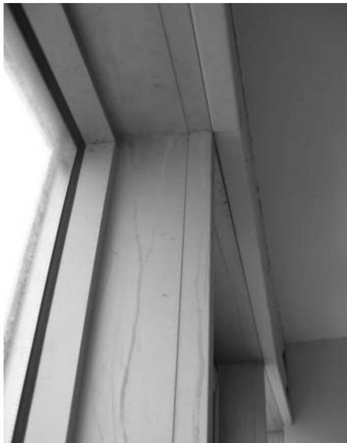
Рис. 4. Наслідки неправильного проектного рішення світлопрозорої частини сучасного будинку
