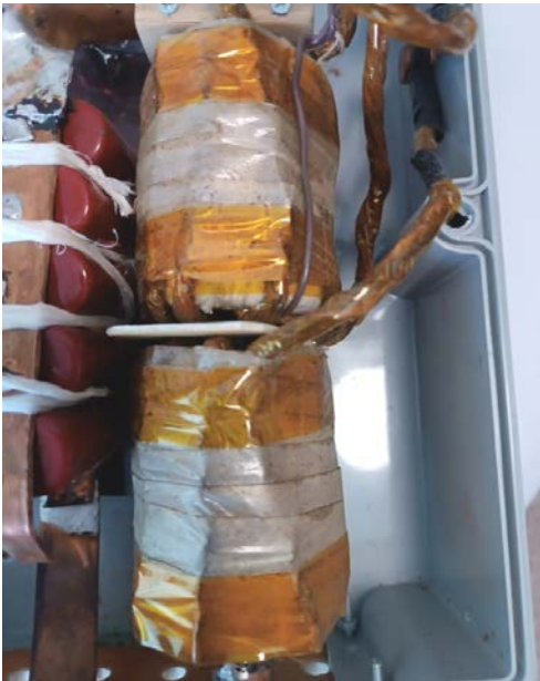
Рис. 6. Вид на трансформаторів зовнішнього блоку
