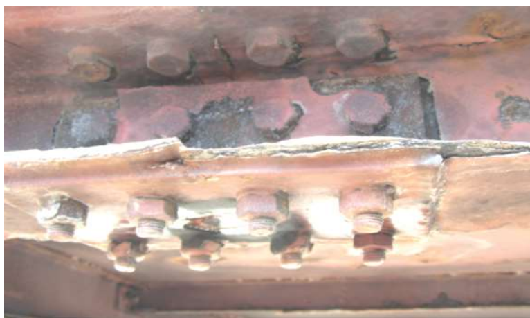
Рисунок 5 – Стан дефектного монтажного стику нижньої балки (поясу) просторової ферми. Шарувата корозія поширення нижньої полиці та нижніх і бічних накладок. Корозійне ураження метизів
