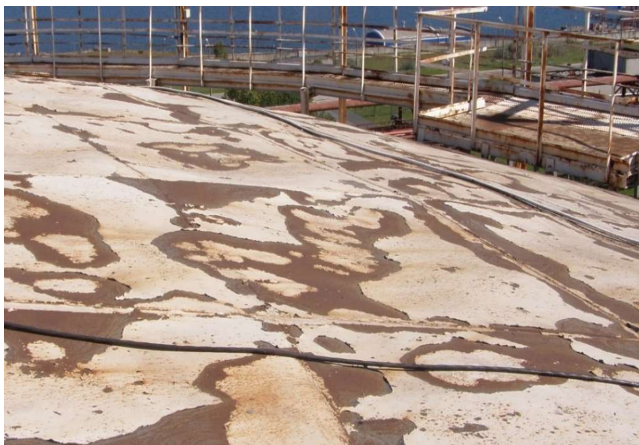
Рисунок 2 – Зовнішній вигляд та технічний стан покриття резервуару. Масова корозія листової зашивки. Ознаки втрати стійкості сегментів даху з південно-східного боку у вигляді понаднормативних увігнутостей.
