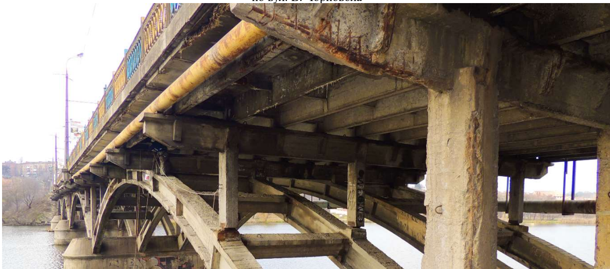
Рисунок 3 – Загальний стан конструкцій арочної прогонової будови мосту по вул. В. Чорновола до реконструкції
