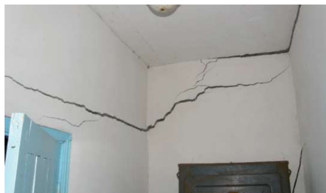
Рисунок 5 – Характерний вигляд тріщин в перегородках безпідвальних приміщень західного блоку через просідання ґрунтів основи
