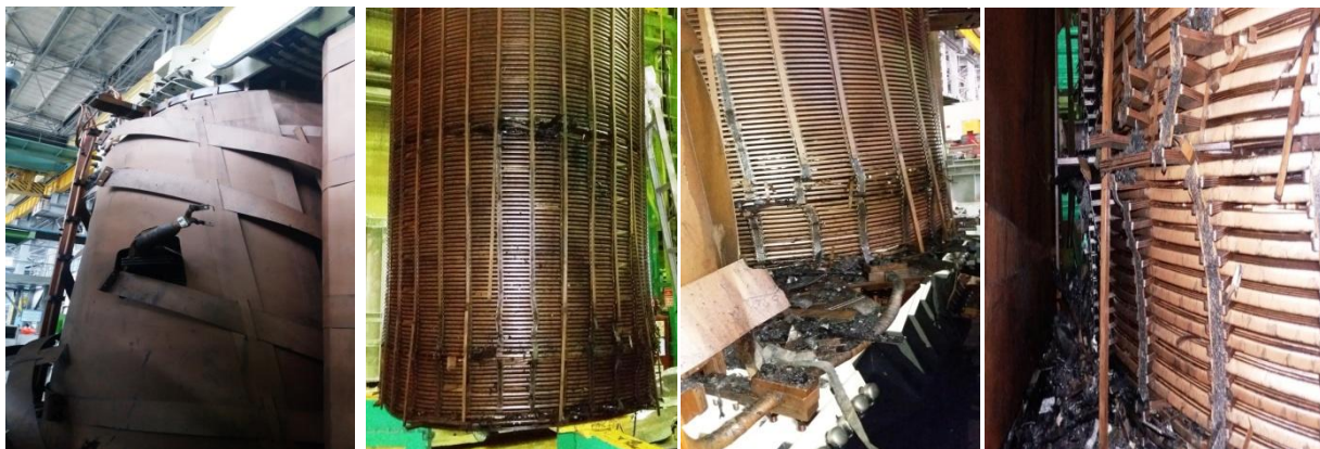
Рисунок 1 – Пошкоджений реактор 750 кВ.
