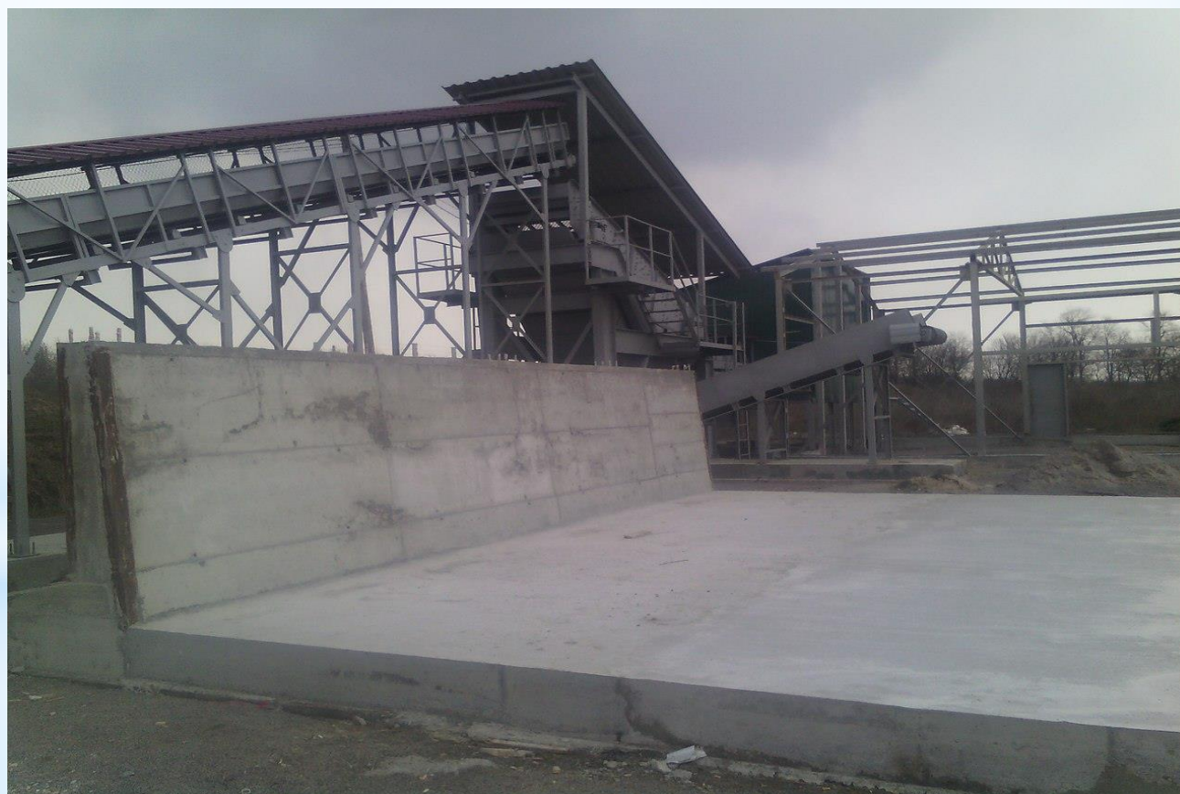
Сміттесортувальна дільниця в м. Калинівка
