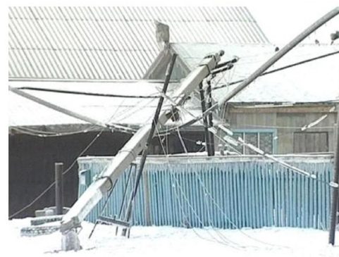
Рисунок Ж.3 – Наслідки ожеледі на повітряних лініях електропередач.
