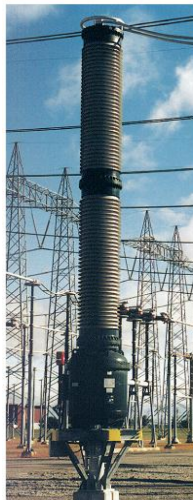
Газонаповненими трансформатор напруги 765 кВ
