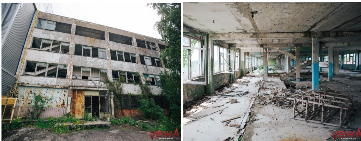
Рисунок 2 – Напівзруйнована будівля на території Вінницького підшипникового заводу
