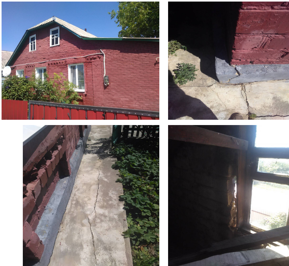
Рис. 2. Руйнування конструкцій внаслідок неправильної експлуатації. Житловий будинок у м. Жмеринка
