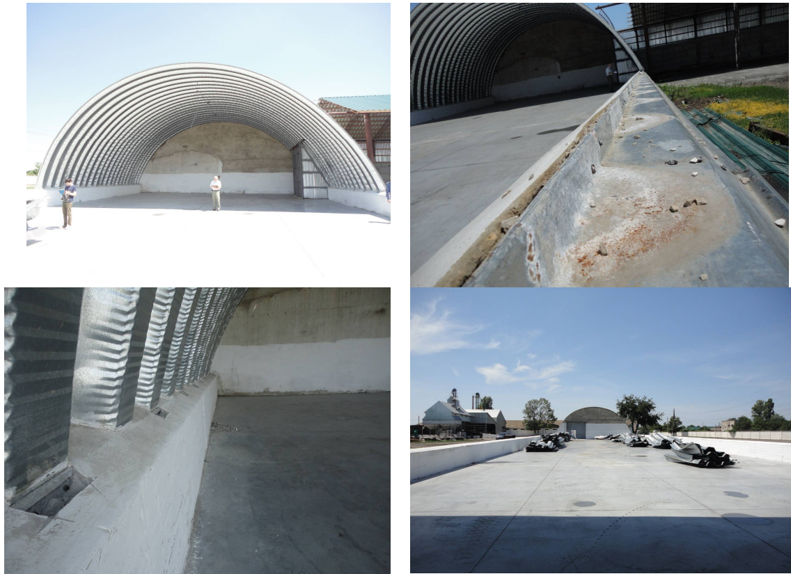
Рис. 1. Руйнування будівлі ангару (смт. Бершадь) внаслідок неякісного виконання будівельних робіт
