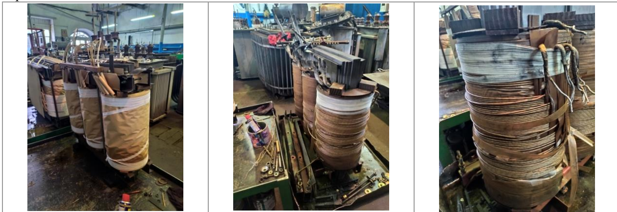
а) Пошкоджені силові трансформатори 10кВ під час ремонту
