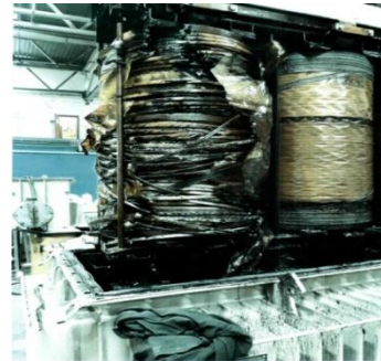
в) обмотки пошкодженого СТ 35 кВ
