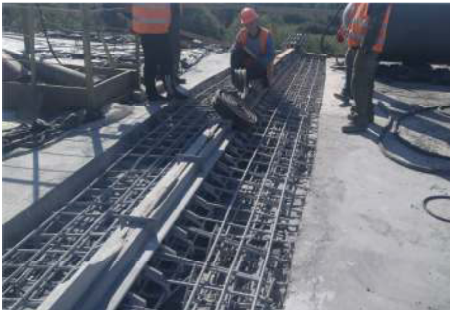
Рисунок 7 – Монтаж металоконструкцій деформаційного шва Mauger D-50 на мостовій споруді у місті Гайсин Вінницької області, що надійно герметизує стик над опорою.
