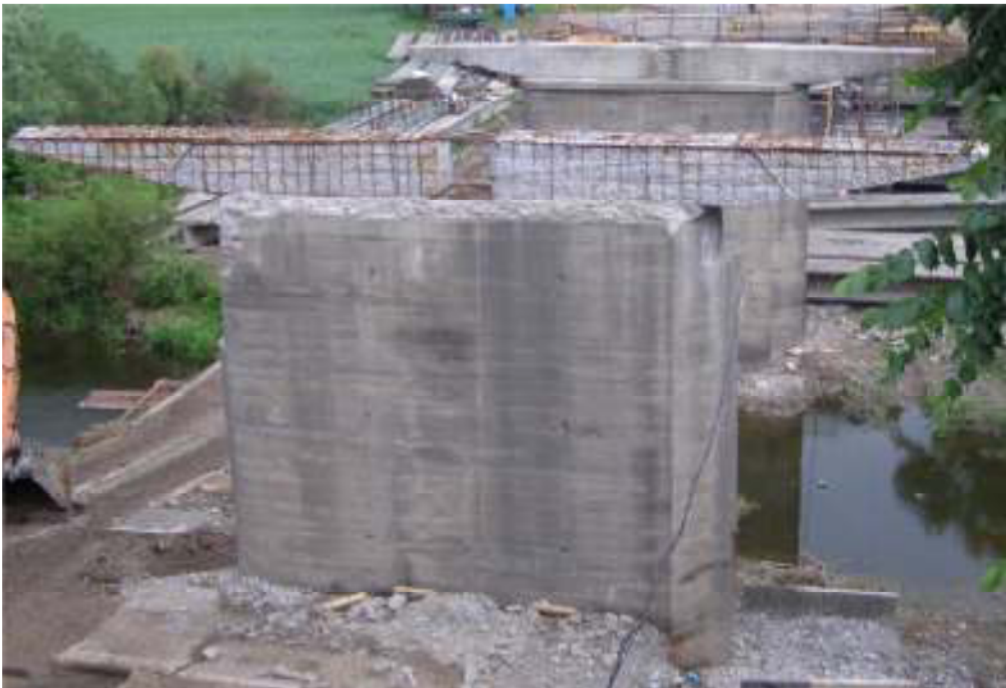
Рисунок 3 – Стан армування ригелів мостових опор після оббивання слабкого бетону. Масова шарувата корозія верхньої (робочої) арматури внаслідок дефектів захисного шару та тривалого замочування.
