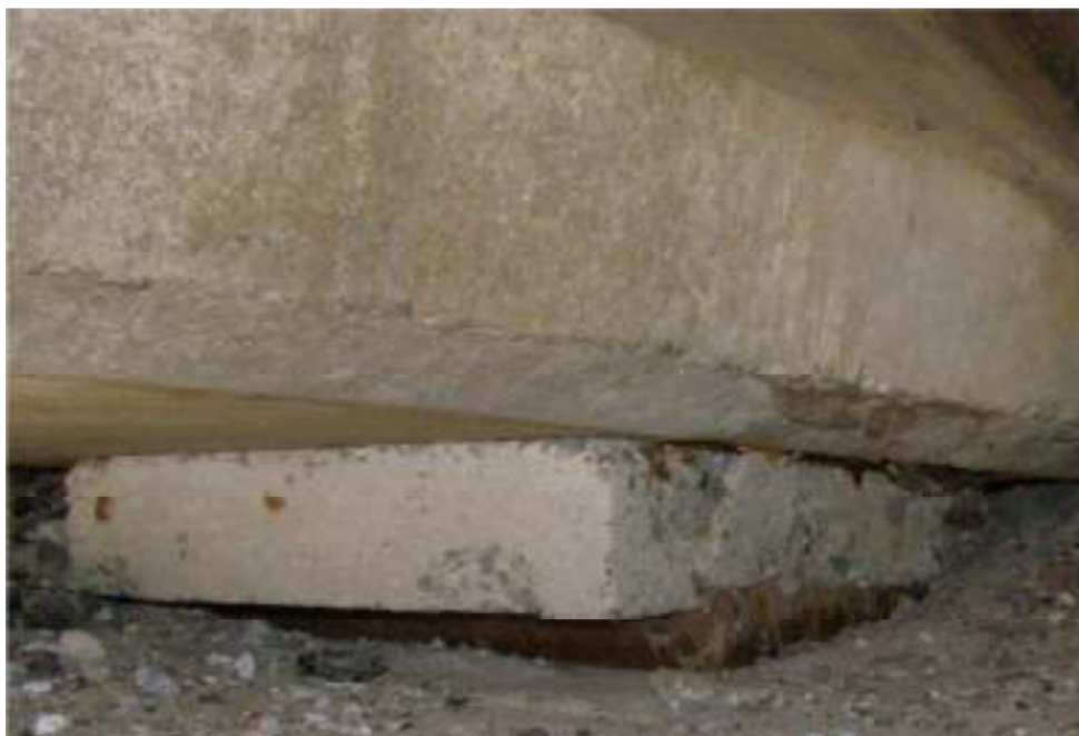
Рисунок 4 – Типовий стан опорних бетонних підферменників під прогоновими балками. Руйнування (розколювання підферменника навпіл).
