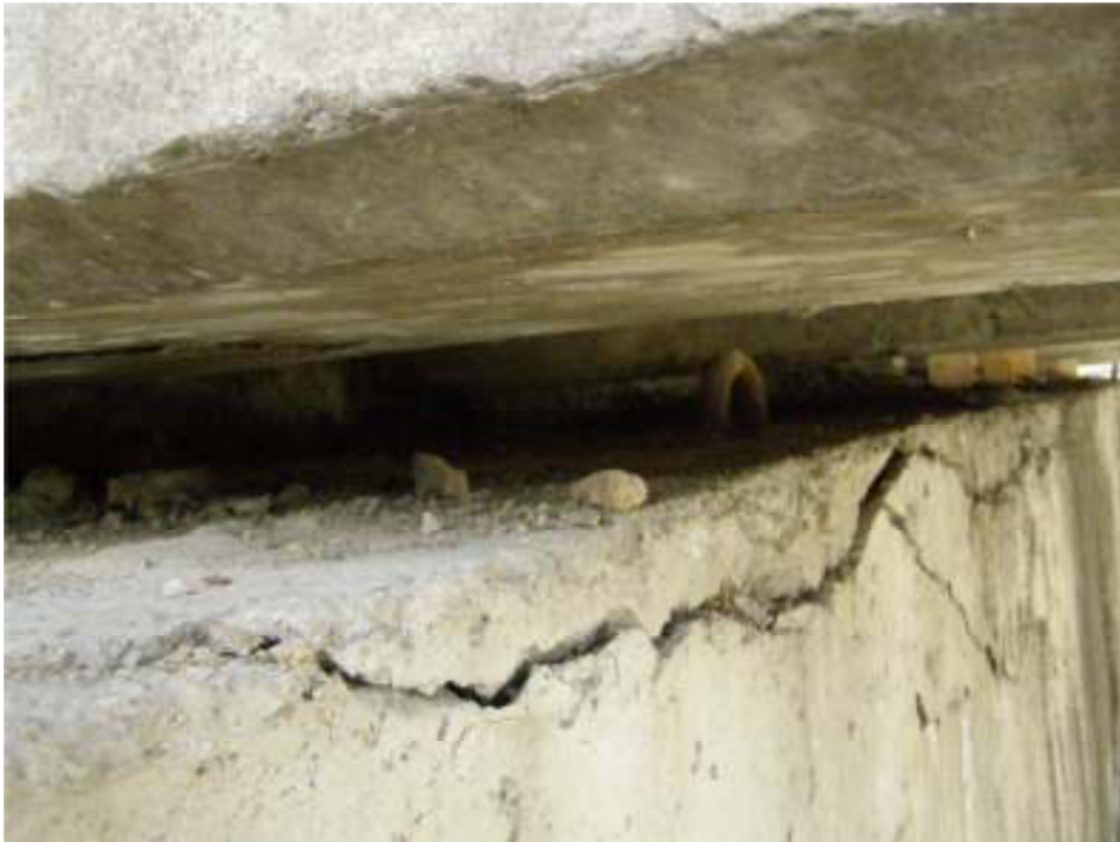
Рисунок 2 – Характерне руйнування (відшарування) захисного шару верхньої (робочої) частини ригеля на консольних звисах мостової опори внаслідок тривалого замочування та збільшення динамічного навантаження на мостову опору через.
