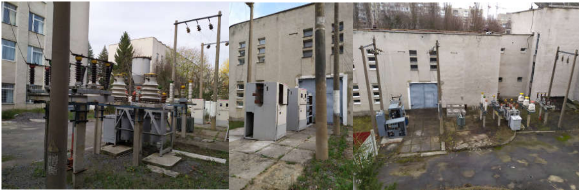
Рис. 23. Навчальний полігон з високовольтним обладнанням (навчальний корпус № 4 ВНТУ).
