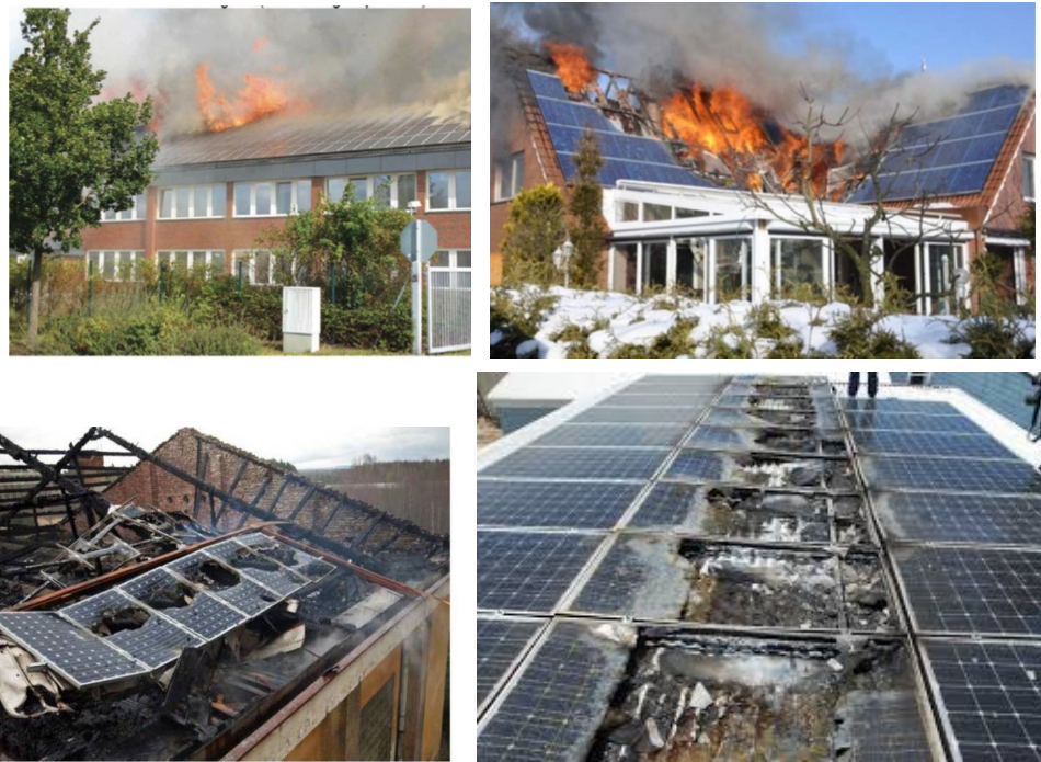
Рисунок А.16 – Результати пошкодження ізоляції та контактних з'єднань
