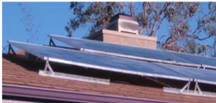
Рисунок А.12 – Помилки монтажу та значне вигинання каркасу ФЕМ
