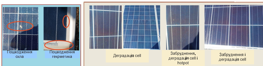
Рисунок А.17 – Пошкодження виявлені на Писарівській ФЕС 3 березня 2021 шляхом візуального огляду
