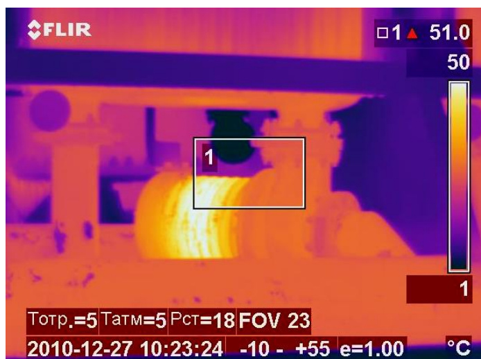
Рисунок 3 – Перегрітий електродвигун масляного насоса системи охолодження
