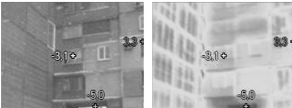
Рис. 3. Неякісна теплоізоляція фасадної системи будинку, тепловтрати через стики стінових панелей та блокування будинків.
