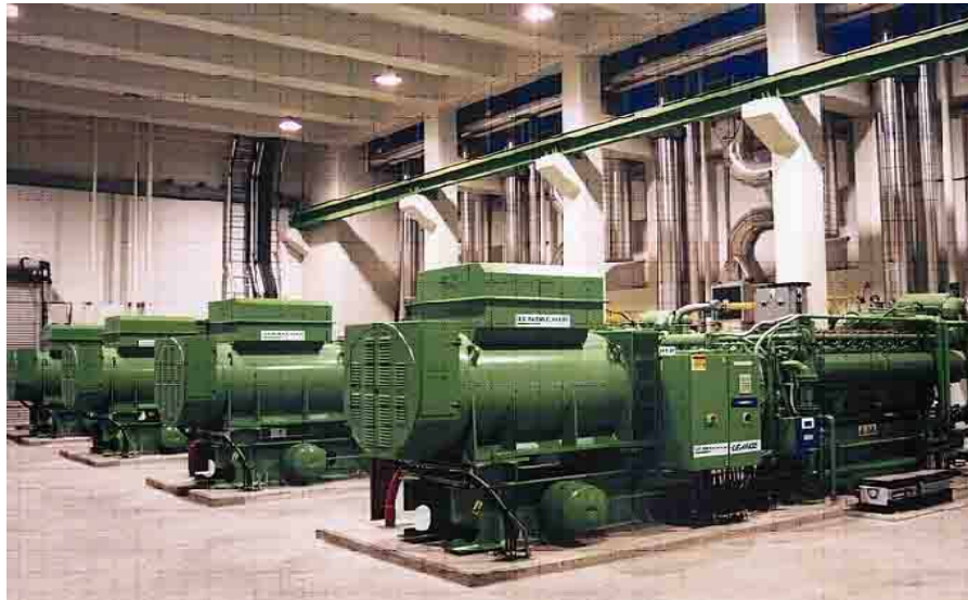
Рисунок 5.3 – Зовнішній вигляд обладнання міні-ТЕЦ з газопоршневими двигунами
