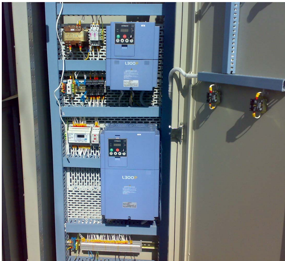
Рисунок 4.6 – Шафа з пристроями автоматичного керування БГУ
