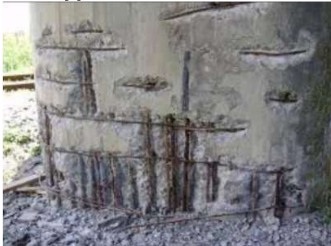
Рис. 1. Корозія залізобетонної конструкції
