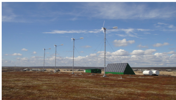
Комплексна енергоустановка в Мурманській області
