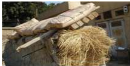
Рисунок 3 – Руйнація стіни А внаслідок нерівномірного навантаження [11]
