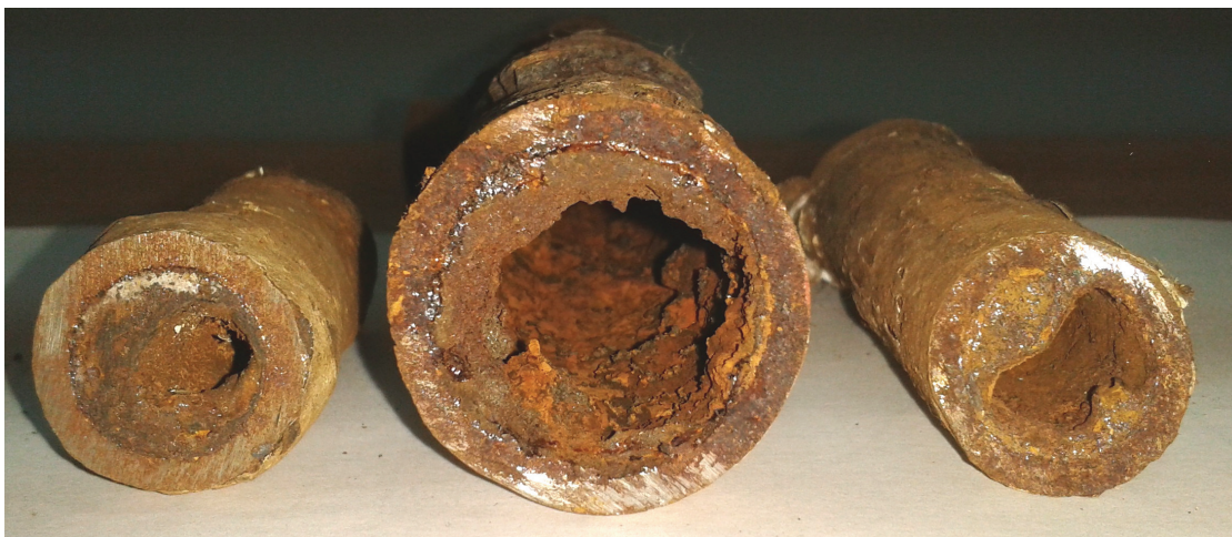
Рис. 1. Перерізи окремих ділянок трубопроводу 5-річного експлуатування цегляного десятиповерхового житлового будинку в м. Запоріжжя
