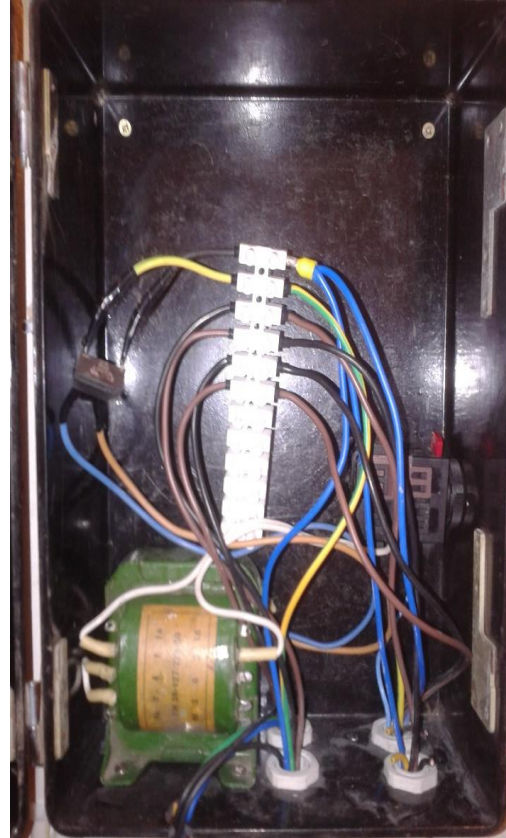
Щит живлення механізму підйому штор
