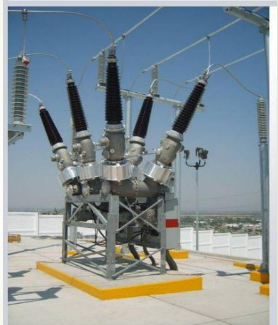
DTC 110 кВ – Siemens AG
