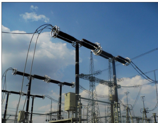
Рисунок 9 – Фото загального вигляду вимикача фірми ABB типу LTV 362-800 (T) E4 (ПС «Західноукраїнська»)
