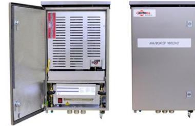
Система моніторингу трансформатора на основі приладів TDM-M І ІНТЕГАЗ
