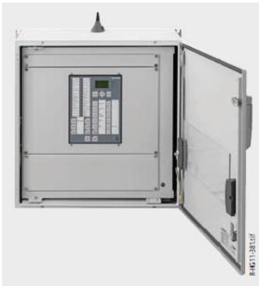
шафа управління з контролером SIPROTEC 7SC80
