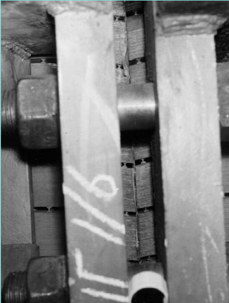
Деформація заліза статора гідрогенератора в місці стику секторів сердечника.
