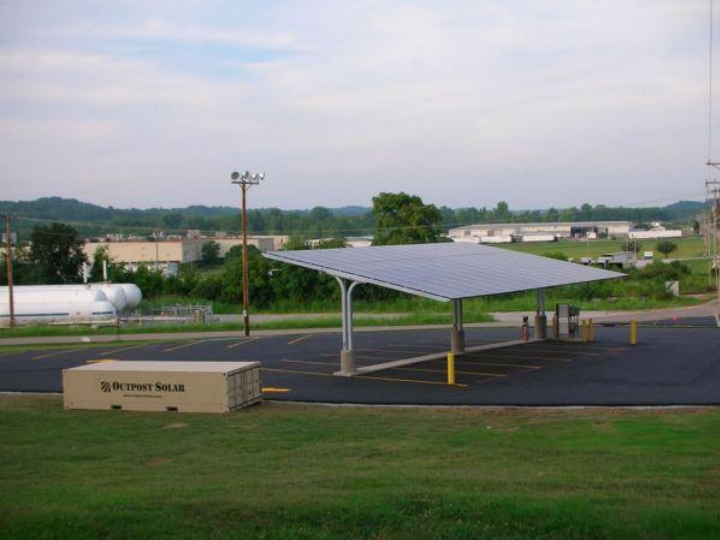
Стоянка з фотоелектричною зарядною станцією
