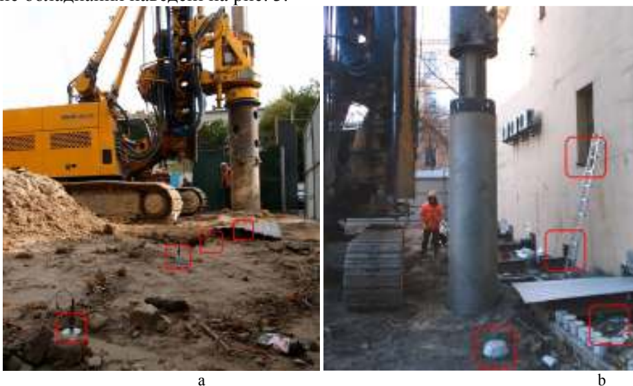
Рисунок 3 – Загальний вигляд бурового обладнання та місць встановлення датчиків вібрації: а – на ґрунті на різних відстанях від свердловини; б – в безпосередній близькості до прилеглої будівлі №1 (на ґрунті перед та за екраном, на фундаменти та стіні першого поверху)
