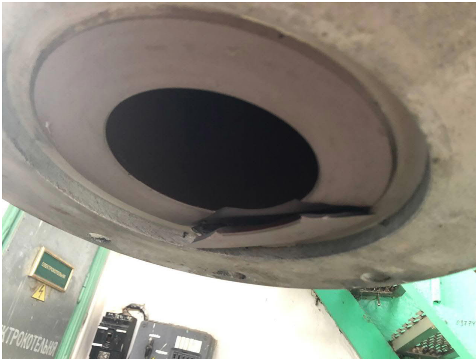
Рис. 1 – Дефект опорного ізолятора елегазового вимикача
