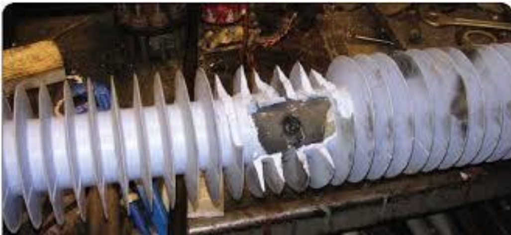
Рис. 2 – Руйнування фарфорового ізолятора
