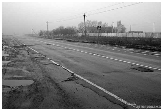
Рис. 4. Нерівність дорожнього покриття
