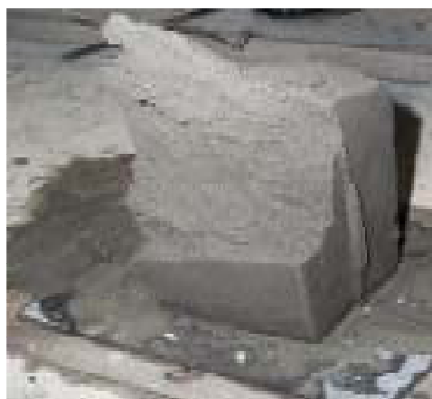
Рис. 2. Характер ущільненої структури дисперсно-армованого бетону після розпалублення
