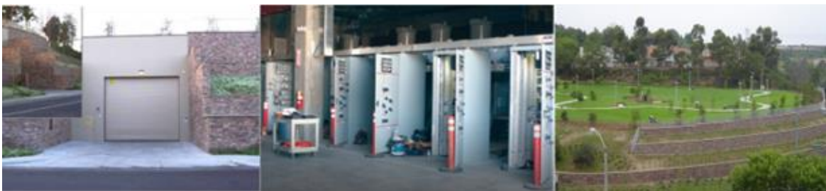
Рис.2 Підземна підстанція у місті Анахайм[1]
