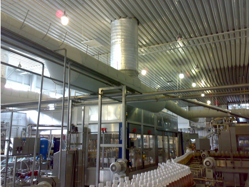
Рис.1– Фрагмент системи текстильного повітророзподілення в цеху з розливу безалкогольних напоїв
