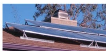
Рис. 30.3. Помилки монтажу та значне вигинання каркасу ФЕМ.
