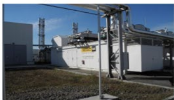
Рис. 48.2. Когенераційна установка 10 МВт.
