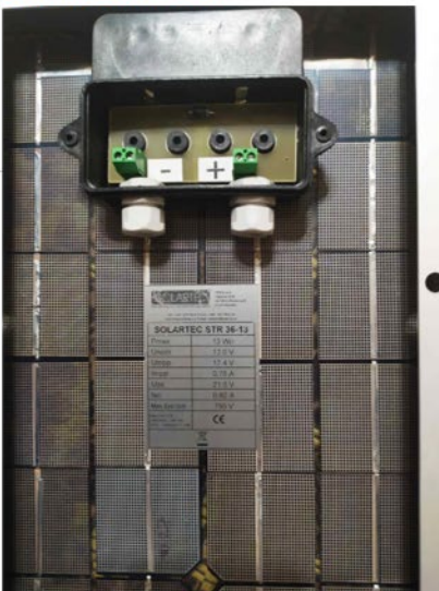
Рис. А.3 Фотоелектричний модуль встановлений на даху ВНТУ і ЗСУ
