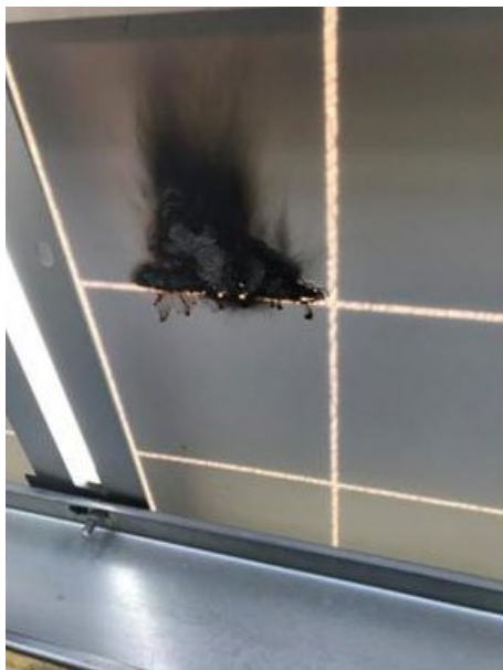
Рис. Б.14. Зростання опору та нагрів контактів в місці з'єднання sells між собою або пошкодження діоду Шоттки.
