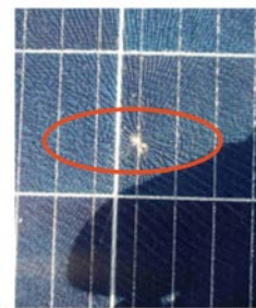
Тріщини на захисному склі ФЕМ.
