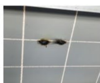
Рис. 30.4. Зростання опору та нагрів контактів в місці з'єднання cells і busbar ФЕМ.
