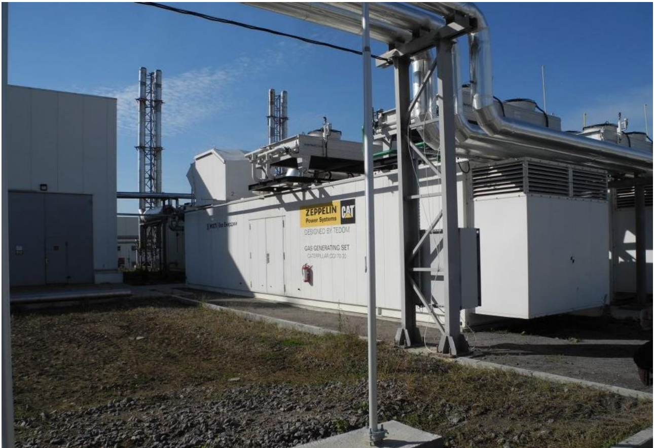
Рис. 5.19. Когенераційна установка 10 МВт.
