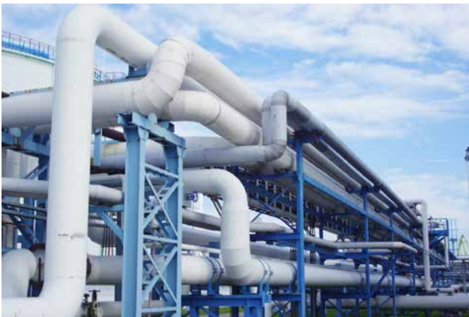
Рис. 1. Трубопровідні мережі (фото Вікіпедія)
